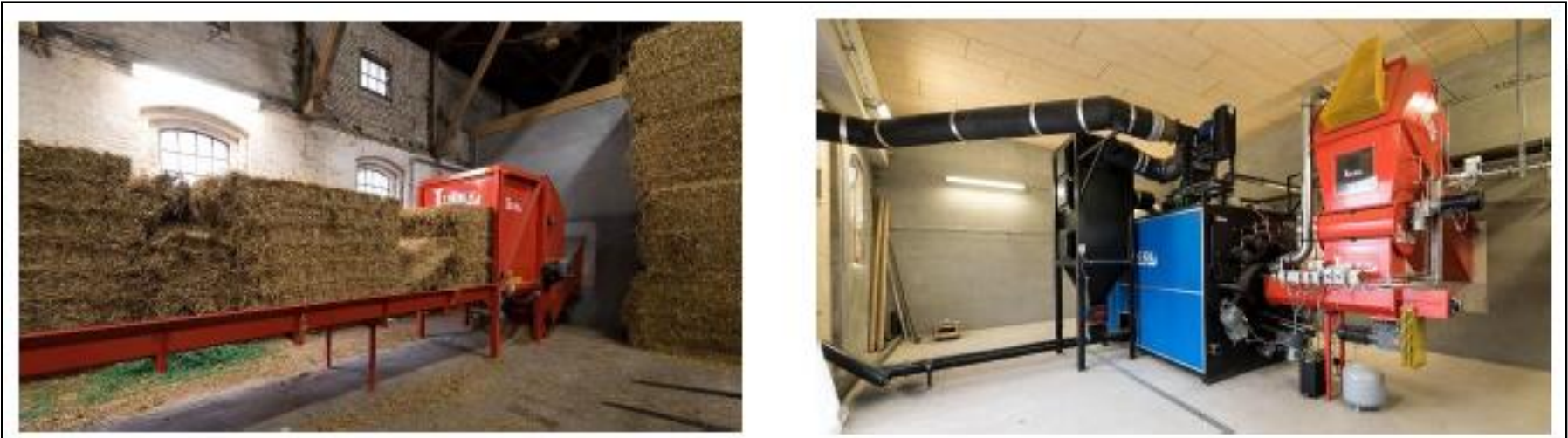
Sursă: AgroBioHeat D3.1- Instalații de Încălzire cu Agrobiomasă
