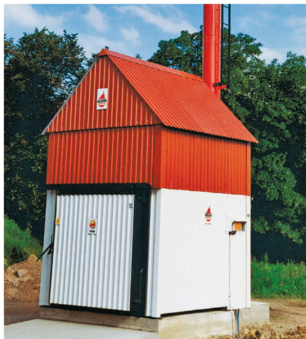
Οι λέβητες τμηματικής τροφοδοσίας εγκαθίστανται συχνά σε ξεχωριστό κτίριο για τη μείωση των κινδύνων πυρκαγιάς. ΦΩΤΟΓΡΑΦΙΑ Torben Skøtt, BioPress.
