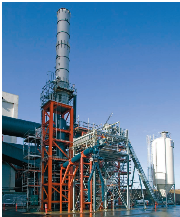
Η μονάδα αεριοποίησης Pyropeer στο Kalundborg. ΦΩΤΟΓΡΑΦΙΑ Torben Skøtt, BioPress.
