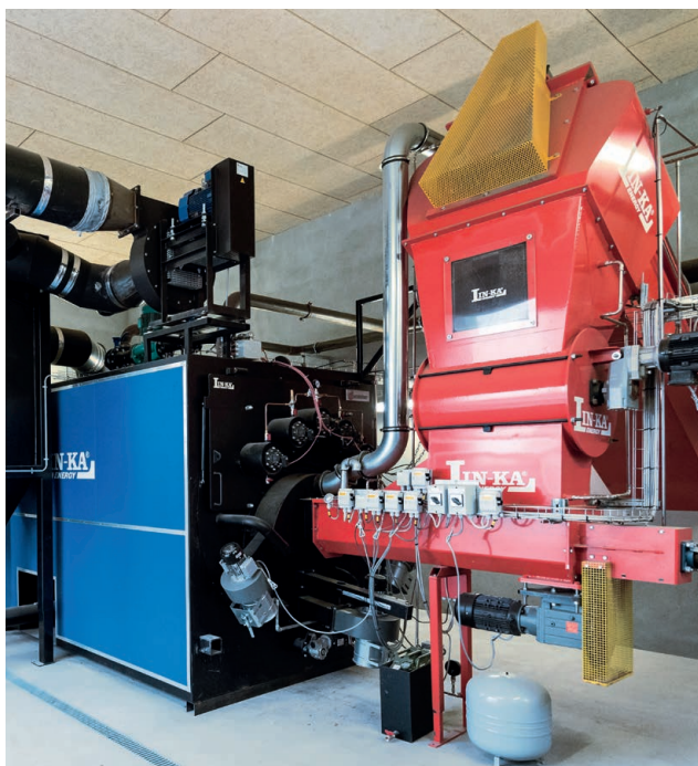
Αυτόματη εγκατάσταση 800 kW από την Linka Energy. ΦΩΤΟΓΡΑΦΙΑ Linka Energy.
