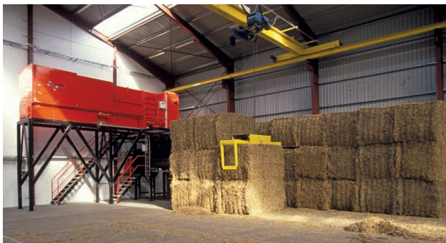
Αποθήκη άχυρου σε μονάδα τηλεθέρμανσης στην περιοχή Terndrup. Η μεταφορά από το χώρο αποθήκευσης στο λέβητα πραγματοποιείται με αυτόματα ελεγχόμενο γερανό. Η αποθήκη μπορεί να περιέχει άχυρο για περίπου μία εβδομάδα λειτουργίας κατά τη διάρκεια του χειμώνα. ΦΩΤΟΓΡΑΦΙΑ Torben Skøtt, BioPress.
