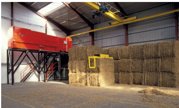
Skladište slame u toplani Terndrup. Prijevoz od skladišta do kotla odvija se automatski upravljanim dizalicom. Spremište može sadržavati slamu tijekom otprilike jednog tjedna rada tijekom zime.
